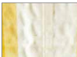
Ondulaciones en el centro de la lona
